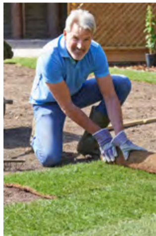
Anlæg af ny græsplæne er blandt de arbejdsopgaver i haven, der udløser Servicefradrag. Foto: Ingimage.com
