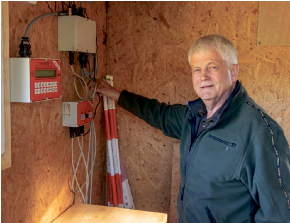
Foto: Edvard Vemmelund viser her det tekniske setup ved det nye compact sporting-anlæg. Alt er automatiseret, så skytterne skal bare tale ned i en mikrofon ude på anlægget – og så kommer der en lerdue susende. Foto: Jim Hoff
